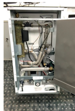
Zugang zu den hydraulischen Komponenten
