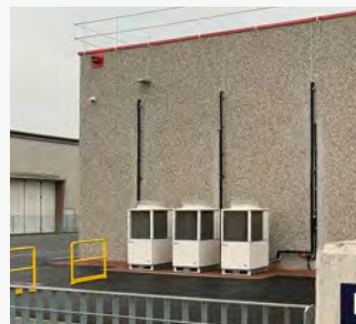
Bofrost. Heimverkauf von Tiefkühl- und Frischkostspezialitäten. Montirone (BS), Italien. Kältetechnik
