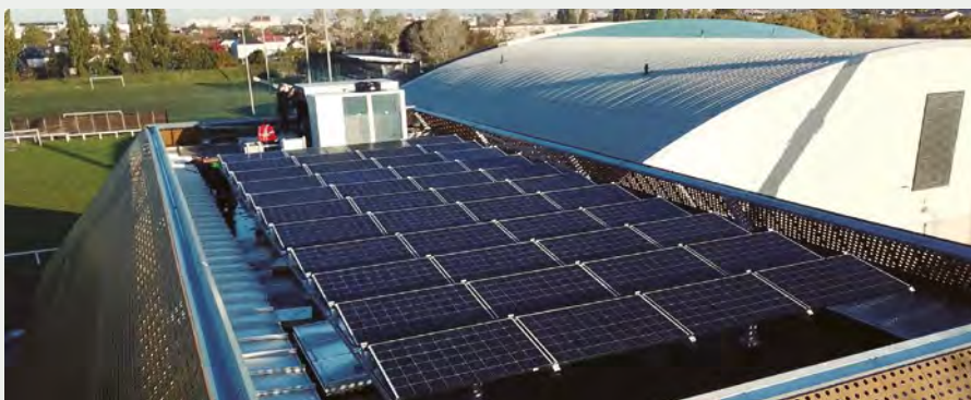
Complexe Sportif des Amandiers. Sportkomplex. Carrières-sur-Seine, Frankreich. ECOi-W
